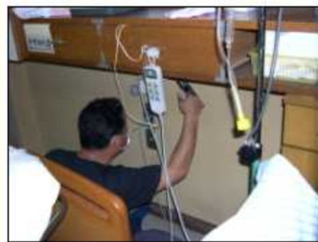
居室内壁の補修工事 壁の老朽化により、壁の補修工事を行いました。
